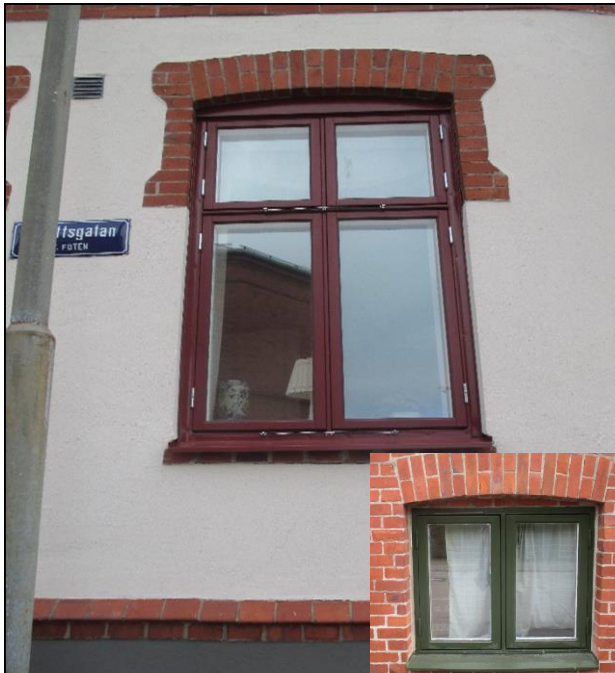
Utgående träfönster samt källarfönster i trä
