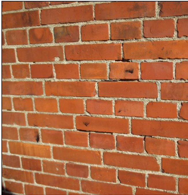
Tegelfasad med sprickor och fogsläpp (sparken)
