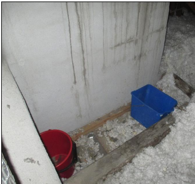
Vattenläckage från tak
