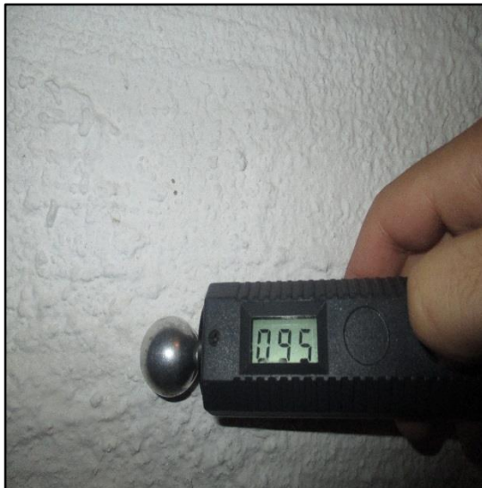
Fuktmätning i källarytterväg visar höga utslag
