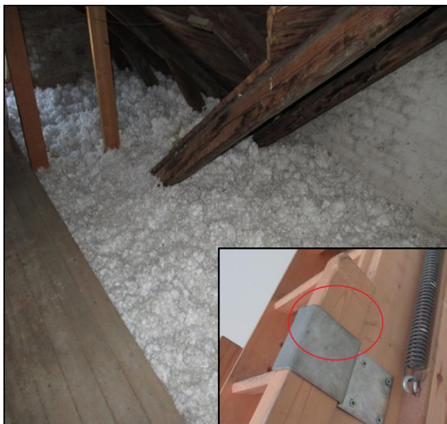
Vind isolerad med lösull samt steg till vind
