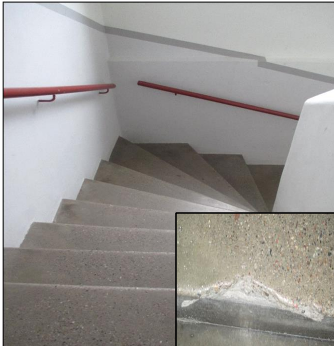
Trapphus samt spricka i trappa
