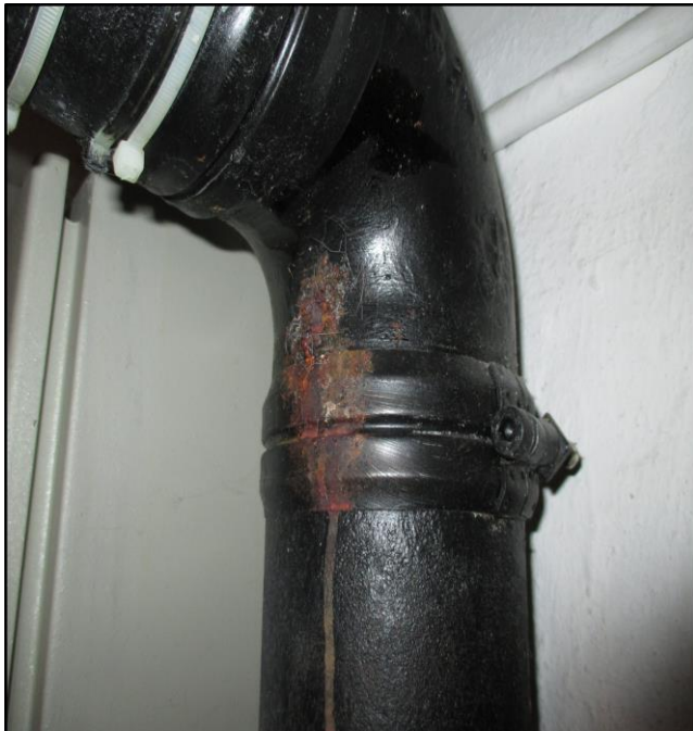
Spillvattenledning med rostutslag
